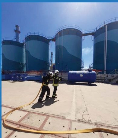
Conato de incendio en la zona del cubeto del tanque diario de gasoil nº2
